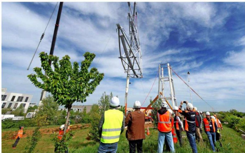
RTE, le gestionnaire du réseau de transport d'électricité, s'apprête à renouveler 85 000 pylônes et 23 500 km de lignes d'ici 2040. Photo Richard Mouillaud
